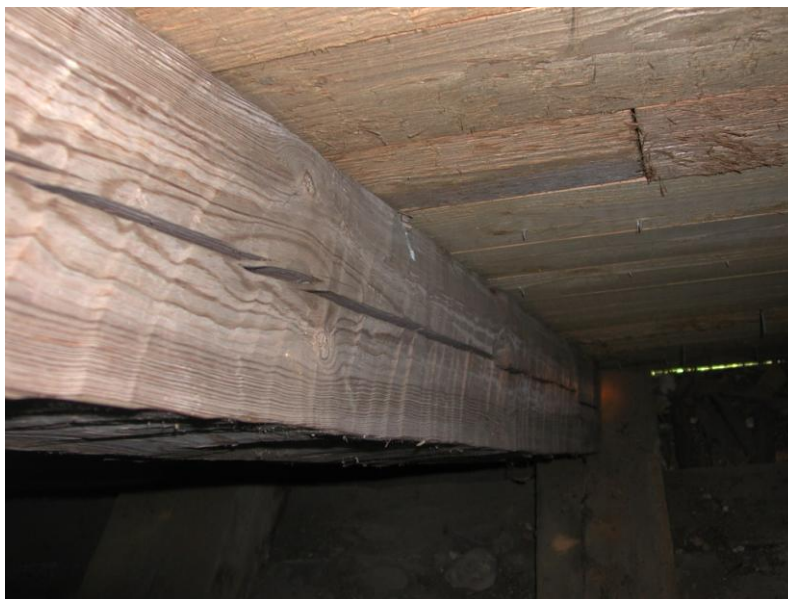
Bild nr5. Sprättäljt högben i nederkant skymtar bindbjälke med underliggande murrem. Foto J. Mårtensson
