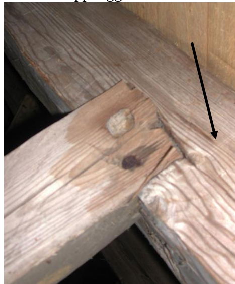
Bild nr 20. Flertalet av takstolarnas sammanfogningar har i efterhand kompletterats med spik. Foto J Mårtensson.
